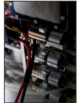
Abb. 05: Luftpumpen unterhalb der Sauerstoffzuführung
